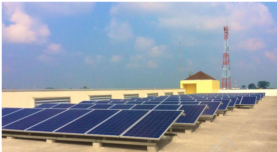
ภาพประกอบ 8 โซลาร์เซลล์ติดตั้งบนดาดฟ้า
