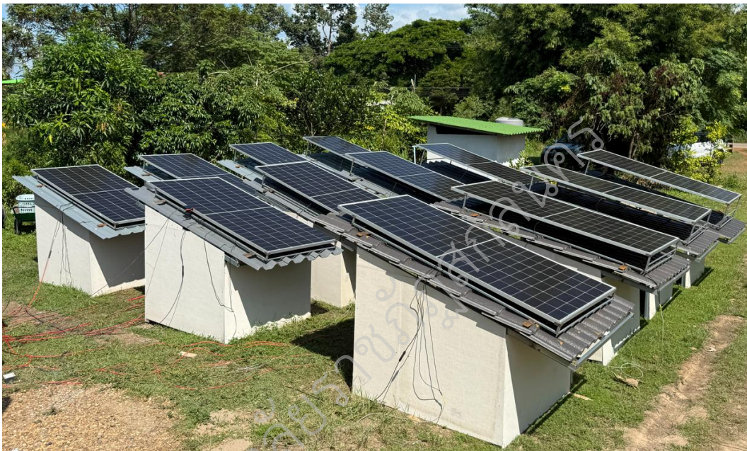
ภาพถ่ายชุดทดสอบประสิทธิภาพแผงโซลาร์เซลล์ขนาด 620 วัตต์ ติดตั้งบนหลังคาคอนกรีต ไฟเบอร์ซีเมนต์ และแผ่นเมทัลชีท ระยะห่างการติดตั้งที่ 10 20 30 และ 40 เซนติเมตร
