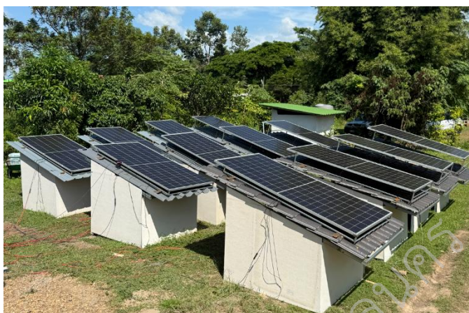
ภาพประกอบ 17 ชุดทดสอบแผงโซลาร์เซลล์บนหลังคา โดยเรียงจากซ้าย หลังคาแผ่นเมทัลชีท กระเบื้องไฟเบอร์ ซีเมนต์ และกระเบื้องคอนกรีต
