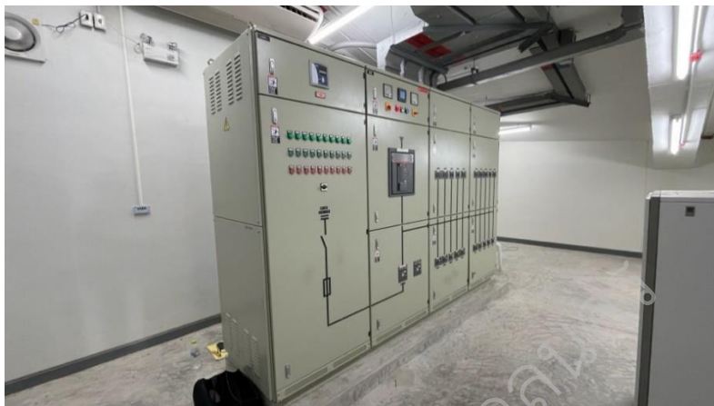
ภาพประกอบ 20 ระบบไฟฟ้าที่จ่ายให้ในการชาร์จของรถรางไฟฟ้า ของอาคาร 19 มหาวิทยาลัยราชภัฏสกลนคร
